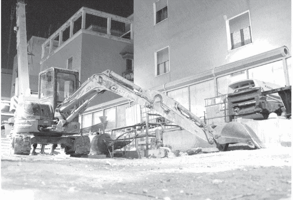
Il cantiere dove è avvenuto l'incidente sul lavoro alla metro C
